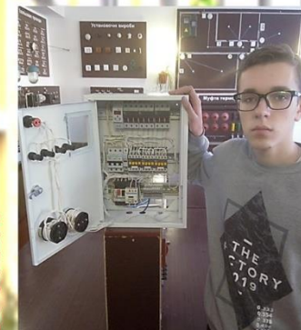
Рис. 3. Автор розробки з щитом керування електрокалориферної установки
